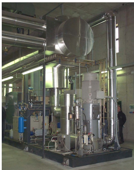
Turbogeneratore da 1.100 kWe installato a Tirano (Sondrio - Italia) nel 2003, applicato a tre caldaie a cippato per una potenza termica complessiva di 20 MWt. Il calore di condensazione è impiegato nella rete di teleriscaldamento (TURBODEN Srl).
